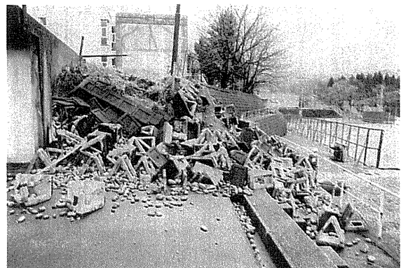
写真-17 崩壊した擁壁
