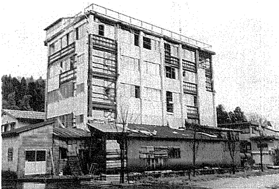
写真-12 小千谷市鉄骨造建物外壁の剥落
