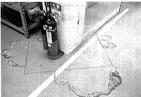
写真-14 工場柱基礎部分の被災状況
