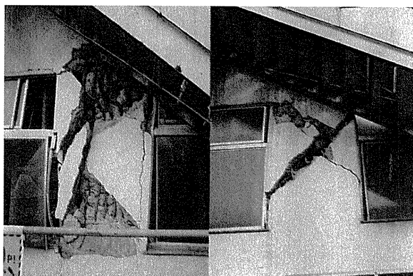
写真-20 RC造建物 柱のせん断破壊 2
