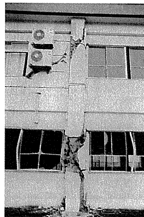
写真-23 柱のせん断破壊
