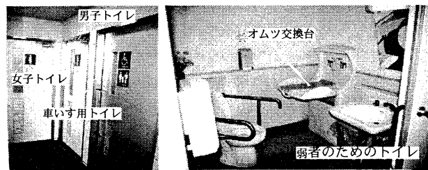
写真3 スーパーマーケットにおけるトイレ設置例
